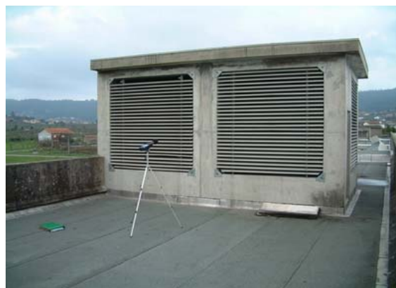
Figura 2 - Fotografia das saídas de ar posicionadas na cobertura
