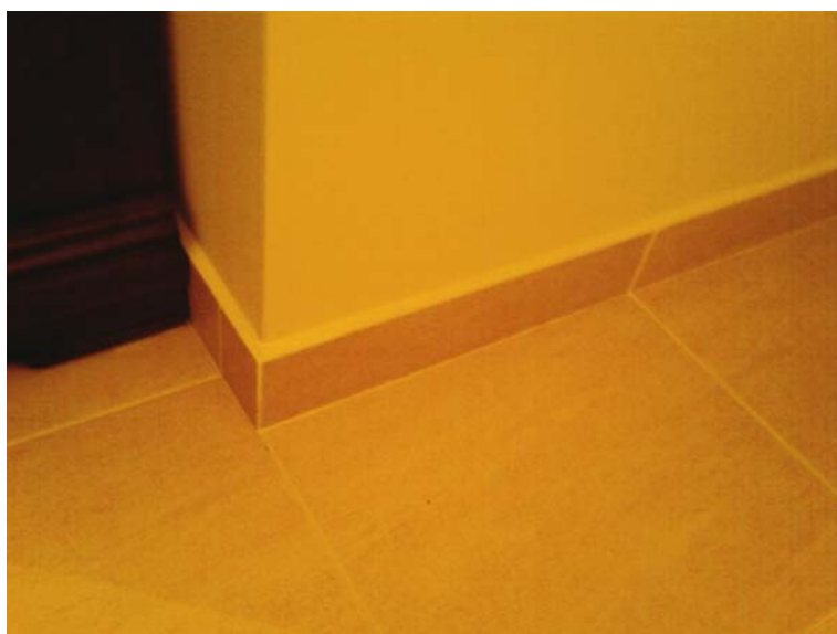
Figura 5 - Pormenor da ligação entre o pavimento e o rodapé num quarto onde é visível a existência de ligações rígidas através do cimento cola de assentamento do revestimento de piso e do rodapé.
